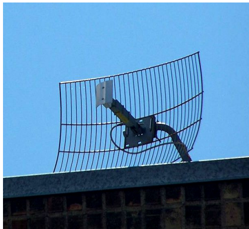
Abb. 4: Parabolantenne im 2.4 [GHz] Band. Ausführung des Reflektors als Metallgitter.
